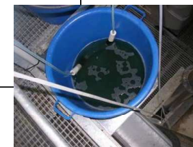
Bac de solution et crépines de pompage
